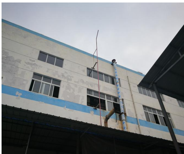
图 4-3 干燥尾气排气筒
