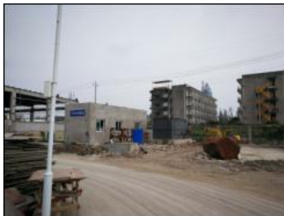
图 4-9 污水处理中清水回用池污水一体化预处理系统（地埋）
