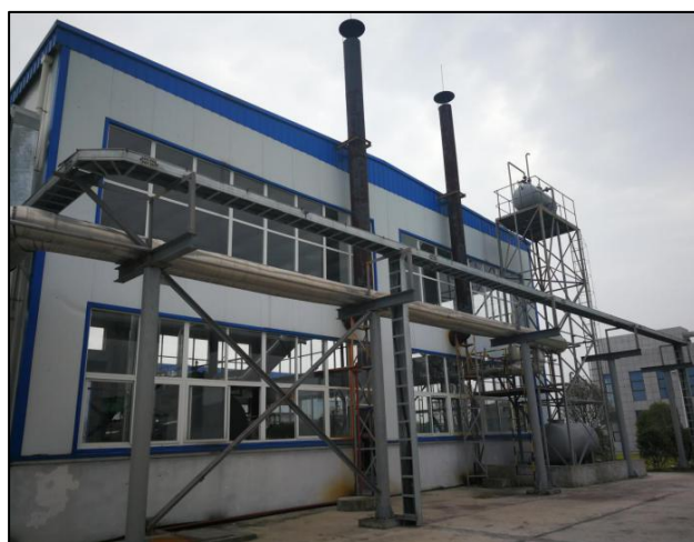
图 4-6 锅炉废气排气筒（左为蒸汽，右为导热油）
